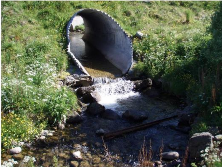
Fig. 67. Høyt sprang ved utløpet av kulverten i Nykvågvasdraget (Foto: Knut Aune Hoseth).
